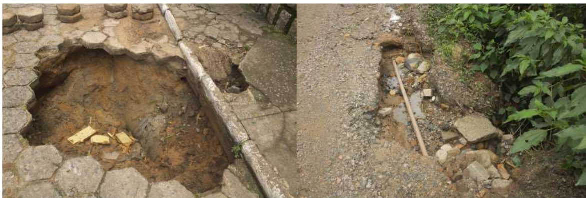
Figura 63 e 64 - Crateras na rua devido a inoperação dos serviços prestados pela prefeitura municipal.
